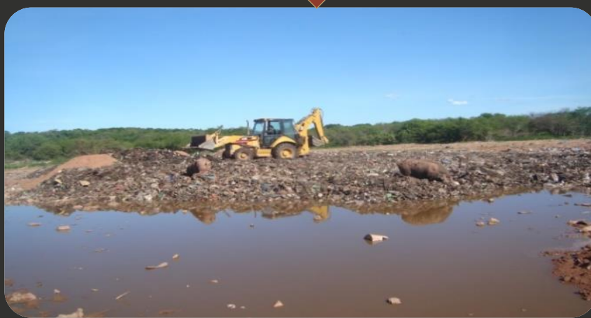
Acumulación de agua de lluvia
